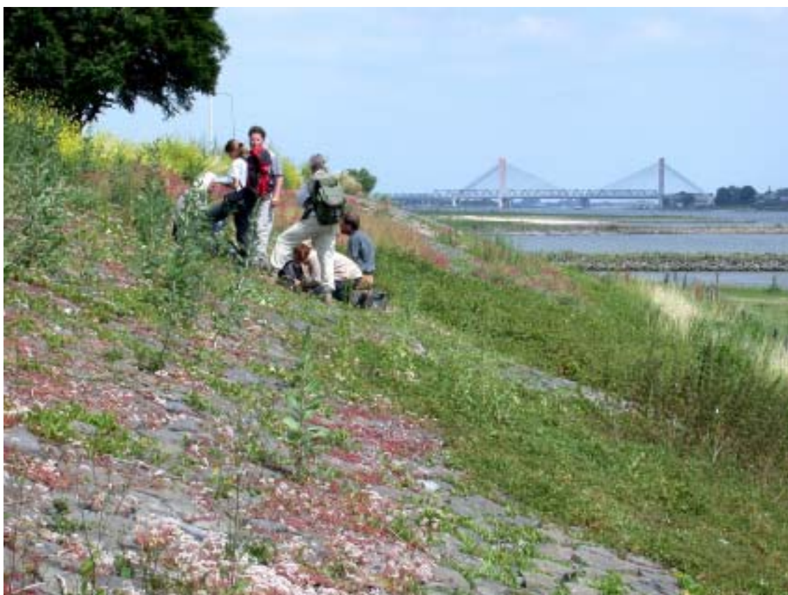
Foto 4. Bij proefvlak Haaften 1 is de begroeiing met wit vetkruid bovenaan beperkt tot de ruimte tussen de basaltzuilen. Onderaan rukken brandnetel en vijfvingerkruid op.
